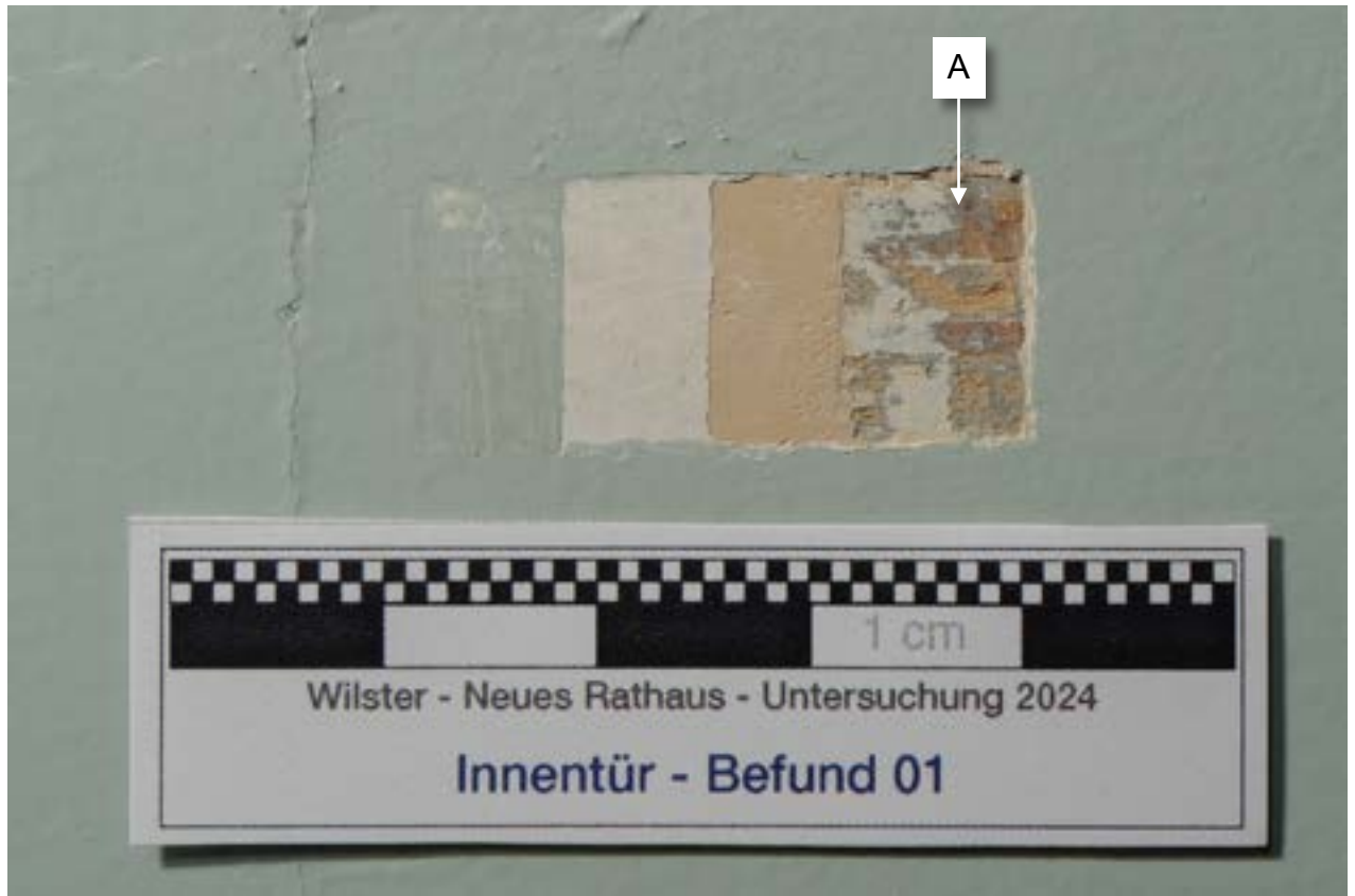
Befund 01 - Innentür - Türblatt - Aufnahme: Q1000289
