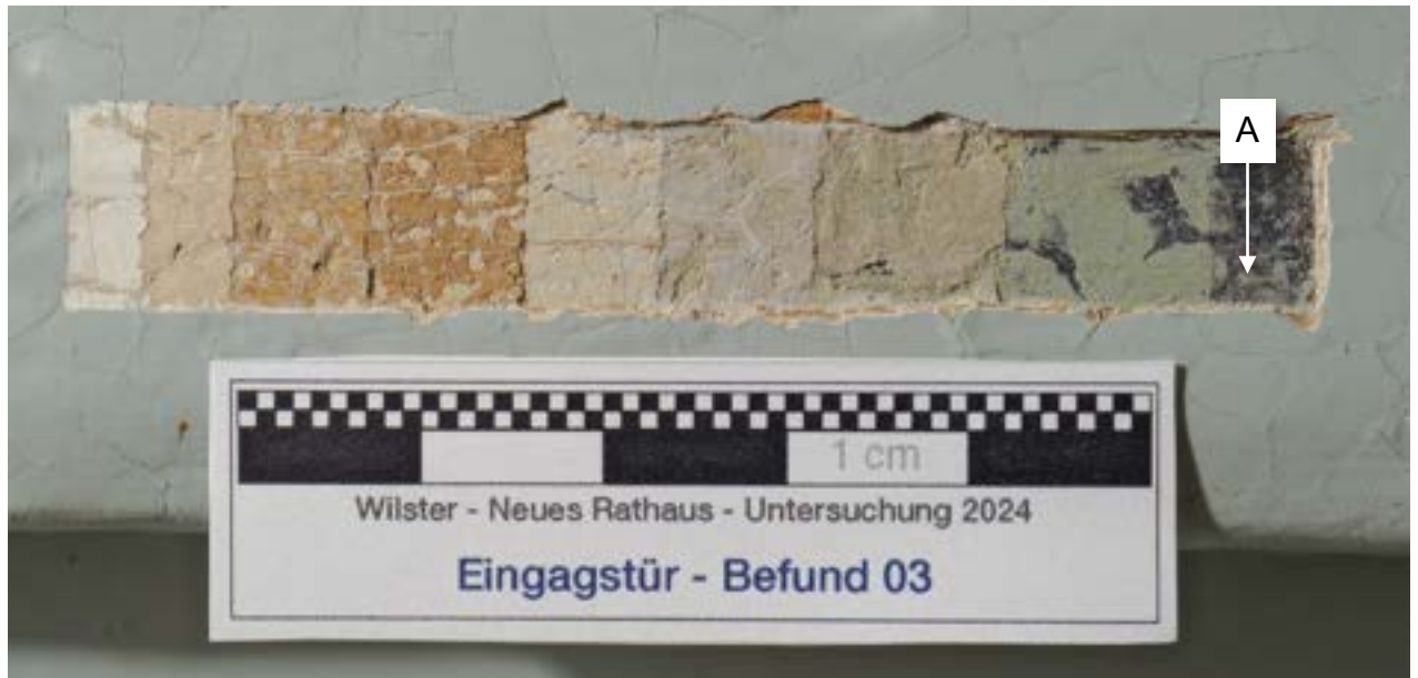
Befund 03 - Innentür - Scharnier - Aufnahme: Q1000287
